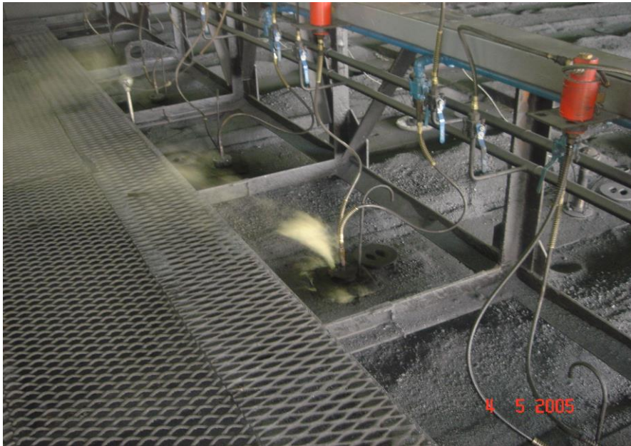
Figura 12 – Forno de cozimento de coque com detalhe da emissão de poluentes orgânicos e inorgânicos gerados pelo refluxo das câmaras.
