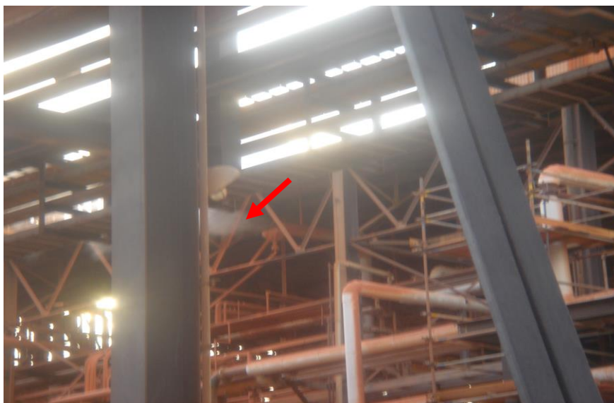
Figura 6 – A adição de soda cáustica e cal geram emissão de vapores cáusticos através dos ventís dos moinhos e conseqüentemente um ambiente insalubre.
